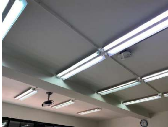
Ilustración 7. Iluminación en el CEIP de Don Modesto
